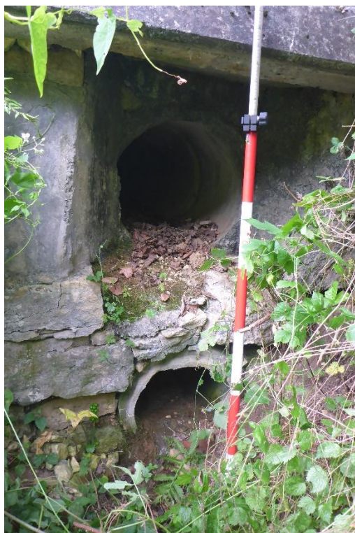
Unterhalb Durchlass D1, das untere Rohr ist der eingedolte Dorfmattbach (dn40cm), das obere Rohr ist ein Notüberlauf für Oberflächenwasser (dn60cm).
