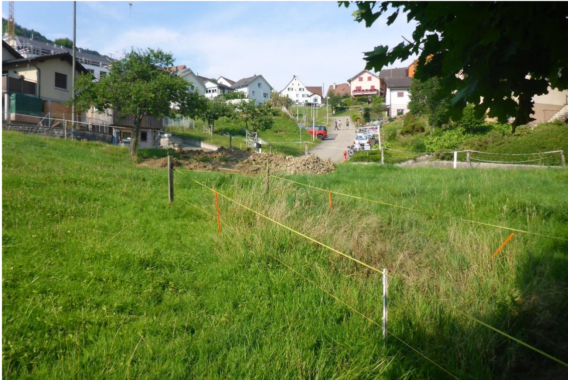
Der Bereich unterhalb der Wahlenstrasse, die Eindolung wurde sondiert. Im vorderen Bildbereich ist die Vernässung, ausgelöst durch die defekte Eindolung zu sehen.
