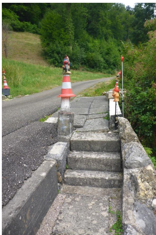
Zufahrt zur Liegenschaft Wahlenstrasse 108, rechts im Bild ist der offene Abschnitt des Dorfmattbachs.
